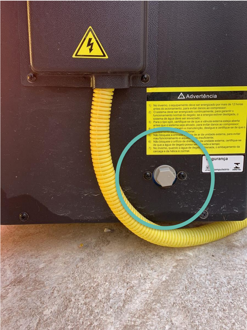
Dreno da água da piscina
