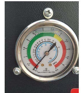
Indício de vazamento do fluido refrigerante
